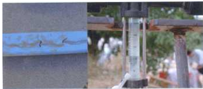
Figura 9. a la izquierda, Tubería de PVC deformada al quedar residuos de la emulsión después del tratamiento. A la derecha venturi para la inyección en riego localizado.
