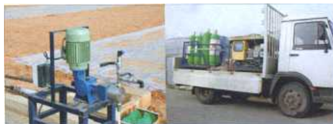
Figura 10. A la izquierda bomba de acero inoxidable, accionada por motor eléctrico. A la derecha sistema de dosificación proporcional gestionado por ordenador.
